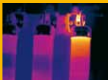
Daños internos en los fusibles
