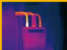
Mala conexión y daños internos
